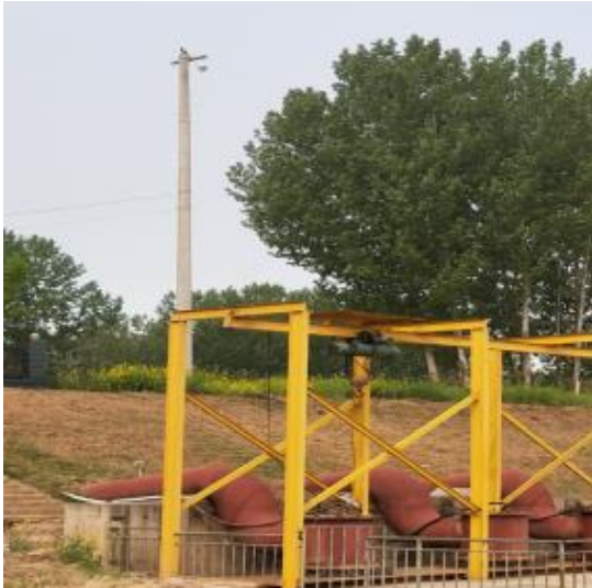
圖 2 白馬泉引黃泵站渠首監控點
